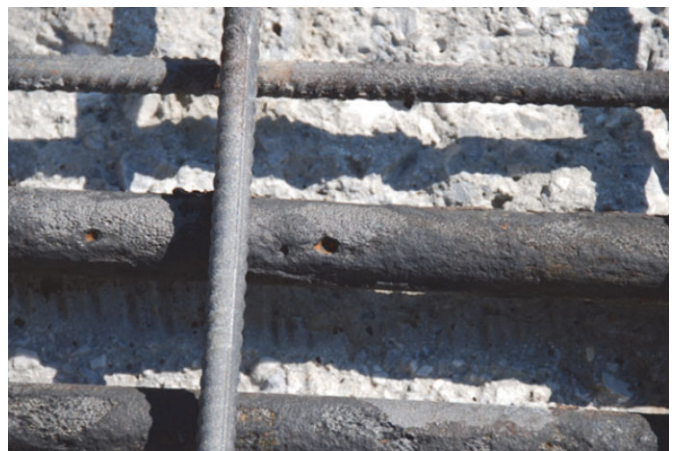
Bild 15 Trotz stark korrodierten Spannglieder und 6 mm tiefen Lochfraßstellen wurden an weit von den Kopplungen entfernten Stellen keine Brüche gefunden Despite heavily corroded tendons and 6 mm deep "pits", no fractures in the tendons were found at locations away from the couplers
